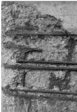
Abb. 2: Betonabplatzung durch oxidierte Stahlstäbe
